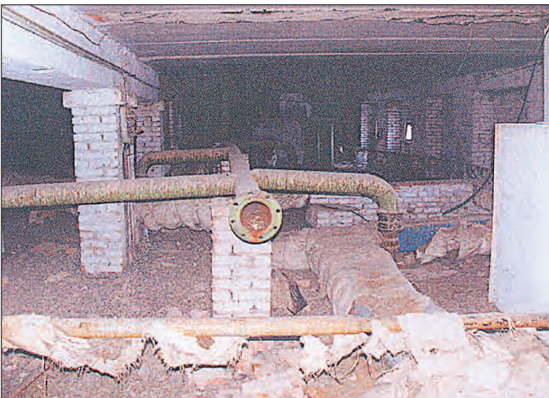
Das Krankenhaus der Singener Partnerstadt Kobeljaki wird durch das undichte Dach immer weiter zerstört. Das Dachgeschoss (im Bild) ist bereits völlig unbenutzbar geworden.
