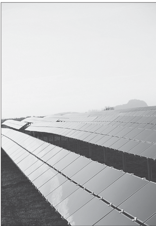
Erzeugt den Strombedarf eines Dorfes in der Größenordnung von Überlingen am Ried: Der neue Solarpark Rickelshausen.
