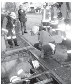
Der Wärmetauscher an den Kühlagregaten eines Supermarkts in Singen hatte an Silvester den Dienst verweigert. Die Feuerwehr rückte deshalb aus.
