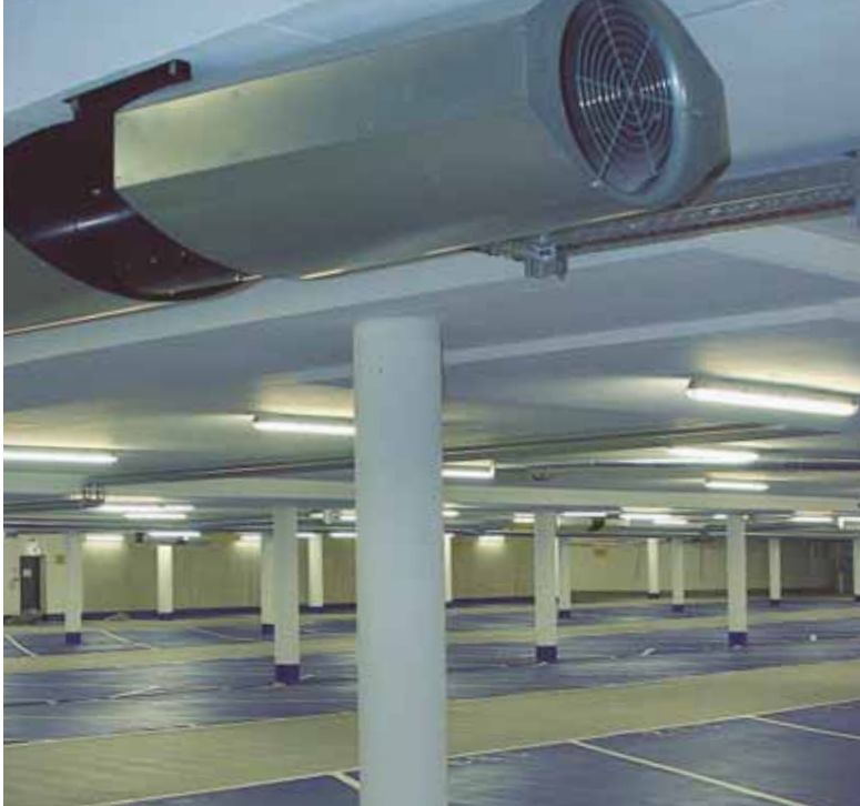
High Tech auch in der Tiefgarage: dicke Luft wird herausgetrieben, Blau sichert Freundlichkeit.
