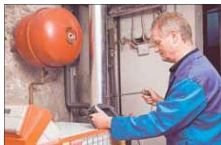
Ein Fachmann bei der Messung von Ventilationsverlusten im Rahmen des Heizungs-Checks. swb-Bild: VZD
