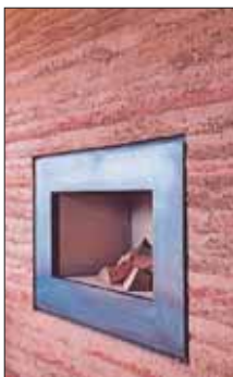
Hinter der Lehmwand mit ihren Wirkungen auf das Raumklima liegt eine intelligente Heizung.
