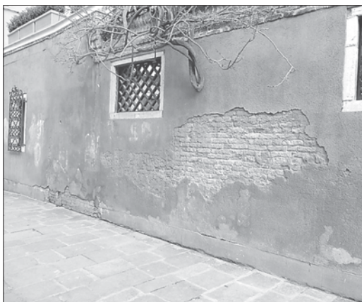
Feuchtigkeit in Mauern ist nicht nur ein ästhetisches Problem - sie kann auch zu Gesundheitsschäden führen.
