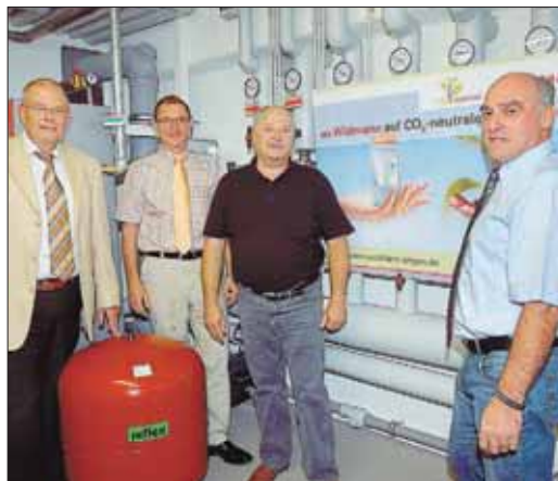
Gemeinsam für das Projekt »CO 2 -neutrales Heizen« hier in der Region: Im Bild Dr. Jürgen Becker (Gas und E-Werk Singen) mit den drei Widmann-Geschäftsführern Michael Kumpf, Rudolf Babeck und Wolfgang Weber.
