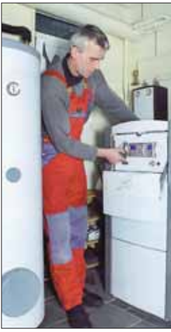
Die Investition in eine neue Heizung rechnet sich angesichts hoher Energiepreise binnen weniger Jahre.
