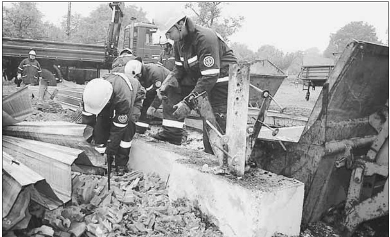
Hilfseinsatz des THW auf dem Schwärzhof in Singen: Nun müssen die Brandreste als Sondermüll entsorgt werden.
