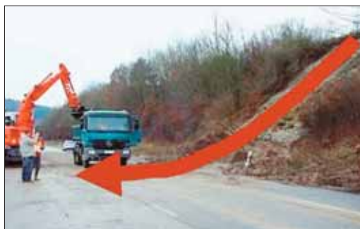
Starkregen konnte auf dem gefrorenen Boden nicht abfließen. Der Druck durch die Wassermassen löste den Erdrutsch aus. swb-Bild: Regierungspräsidium Freiburg
