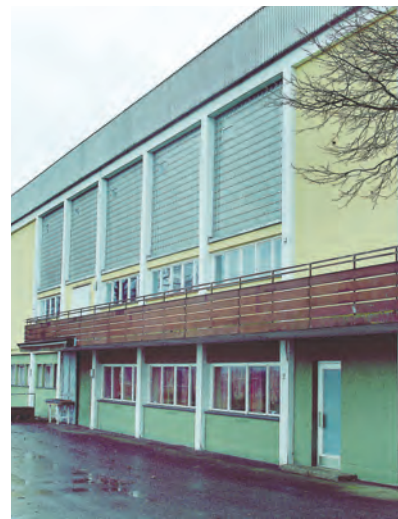
Die Sanierung der Randegger Grenzlandhalle soll in den Pfingstferien beginnen.
