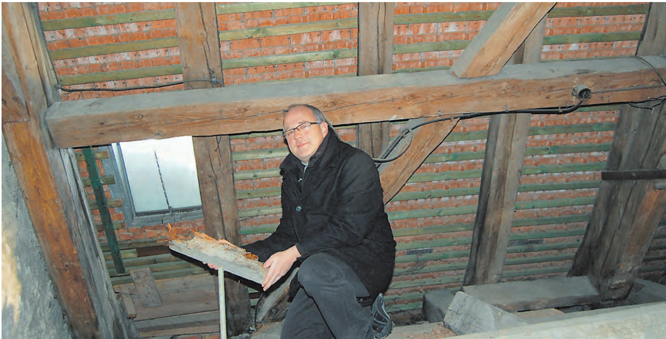
Pfarrer Matthias Zimmermann zeigt die maroden Dachbalken, die bei der Sanierung der Stadtkirche ersetzt werden müssen.
