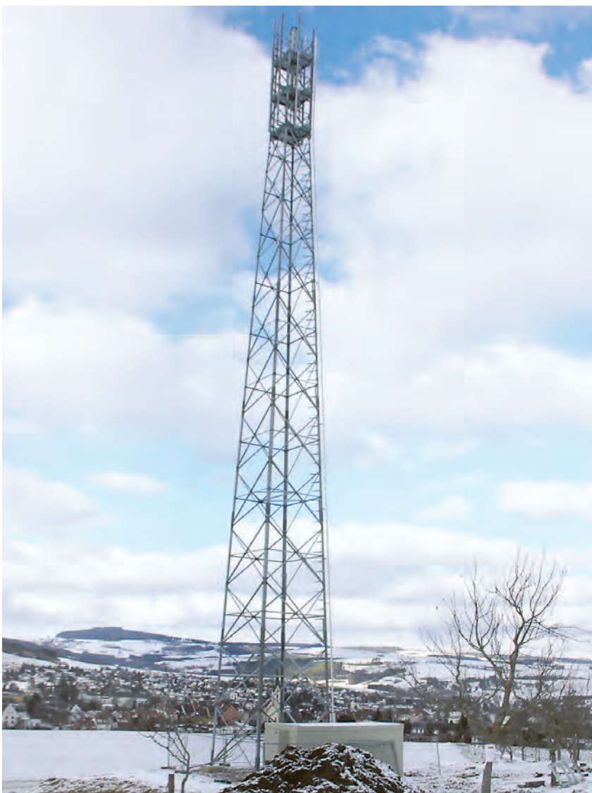
Der ungeliebte Zankapfel: Der Funkmast am Schoren wurde trotz massiven Widerstands von »Pro Engen« gebaut und soll im nächsten Frühjahr in Betrieb gehen.
