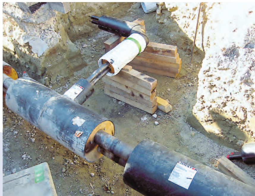
Ein Hauptrohr mit Abzweig für die Versorgung von weiteren Abnehmern.
