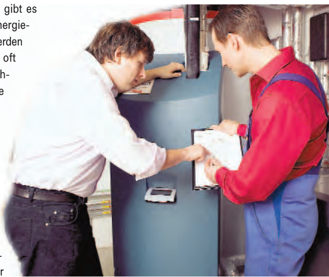
Um Energiekosten zu sparen, sollte man die Hilfe von Profis in Anspruch nehmen. swb-Bild: shk
