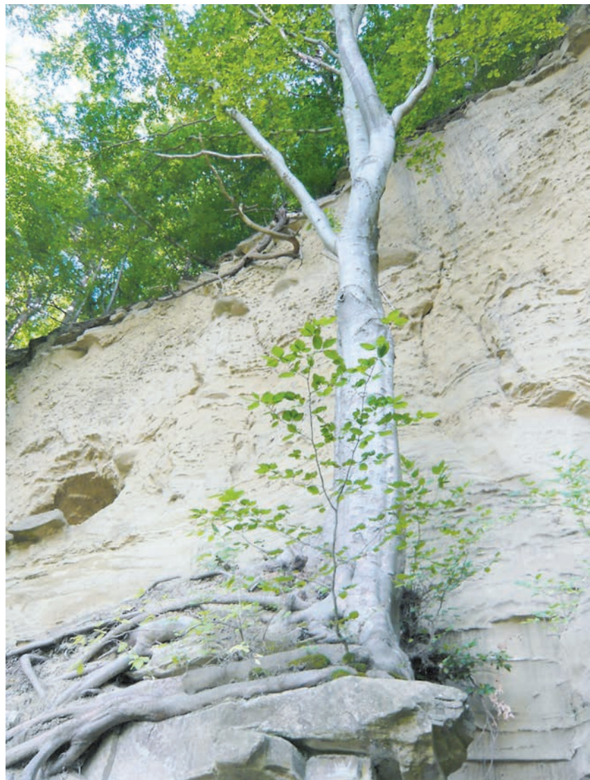
Die »Heidenhöhlen« waren gesperrt worden, nachdem in einem Gutachten des geologischen Landesamtes eine Gefährdung festgestellt worden war. Sicherungsmaßnahmen sollen im Dezember durchgeführt werden.
