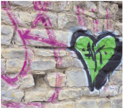
Rücksichtslose Vandalen haben den »Alten Turm« in Aach verunstaltet.
