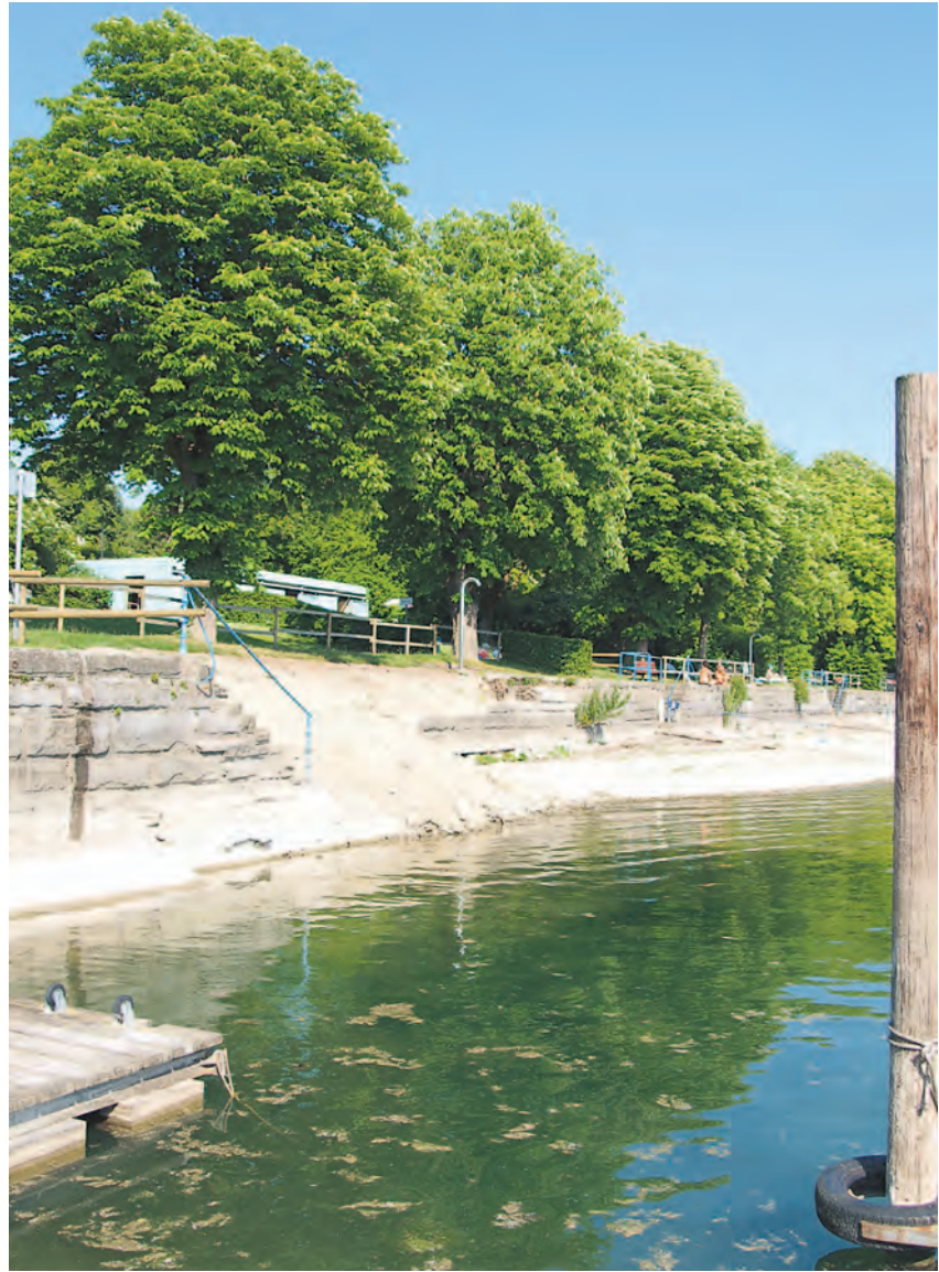
Was wird aus der sanierungsbedürftigen Ufermauer und dem Seebad? Besonders ältere Radolfzeller Bürger fürchten um »ihr« Seebad. swb-Foto: Kempf
