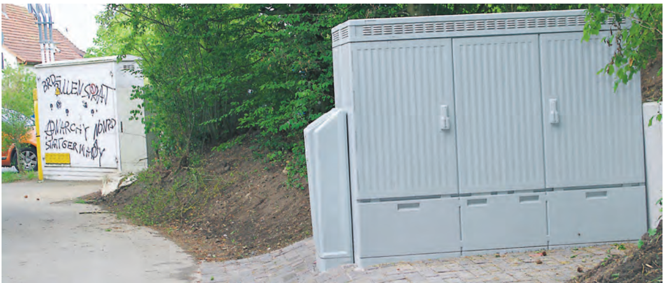
Die Überlinger können sich freuen. Die neue Verteilanlage für schnelles Internet am südlichen Ortsrand durch den Anbieter Telekom hat in diesen Tagen ihren Betrieb aufgenommen.
