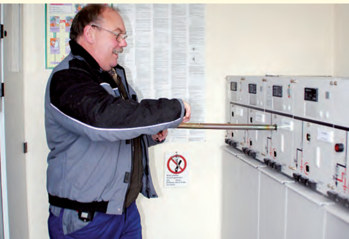
Die letzten Überprüfungen für die Stromnetzübernahme (hier Trafostation in Möggingen) sind im Gange.
