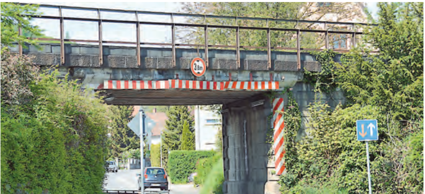
Die Eisenbahnbrücke der Hilzinger Straße in Gottmadingen muss dringend erneuert werden. Doch das Land Baden-Württemberg hat kein Geld für den Bau der notwendigen Straße, Rad- und Gehwege. swb-Bild: mu
