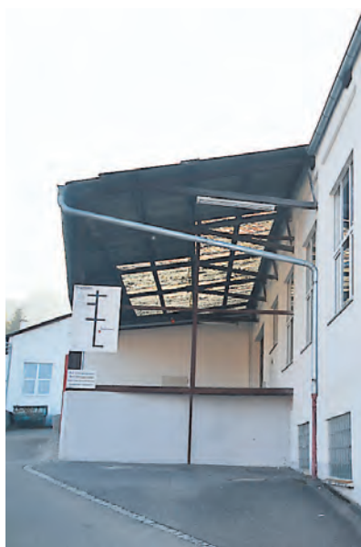
Die Brache des ehemaligen »Bank-Areals« im Mühlhauser Ortskern soll im Rahmen des Landessanierungsprogramms besser genutzt werden. swb-Bild: mu
