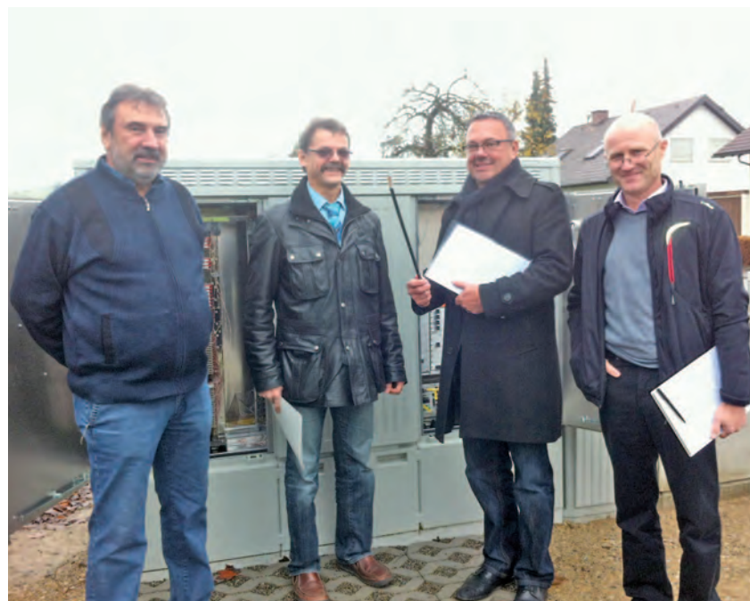
Bürgermeister Hans-Peter Lehmann (m.) mit den Verantwortlichen von der Telekom bei der Inbetriebnahme des Breitbandnetzwerkes. swb-Bild: lkr
