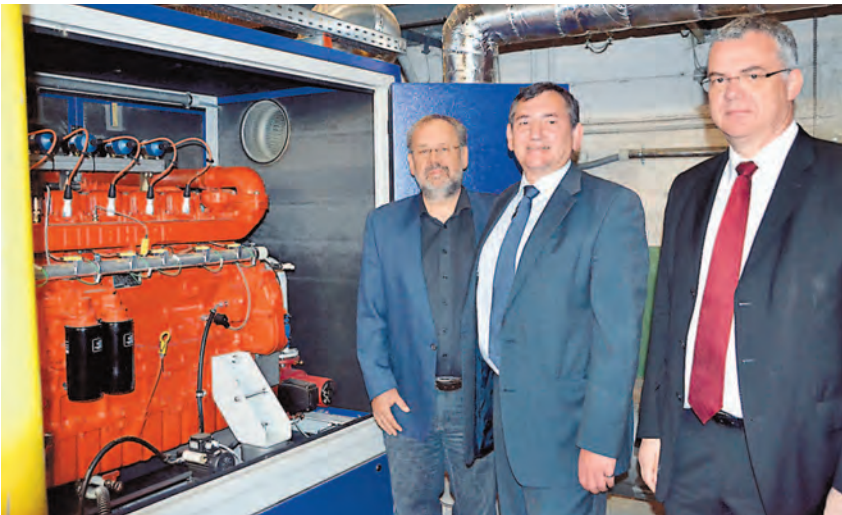
Eine Investition in die Zukunft: Reinhold Greuter, Leiter der HBH-Abteilung »Technik«, HBH-Geschäftsführer Peter Fischer und Oberbürgermeister Dr. Jörg Schmidt zeigen das neue BHKW im Radolfzeller Krankenhaus. swb-Bild: gü
