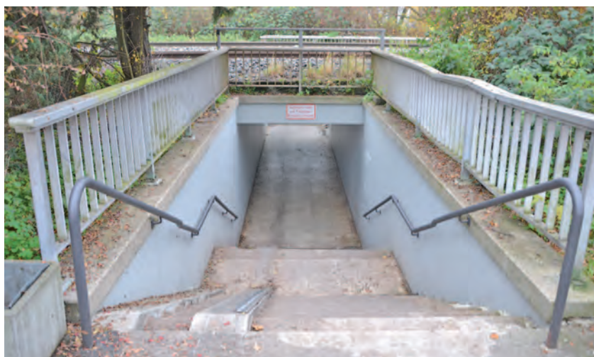
Das Objekt der Begierde: Die Bahnunterführung am Libellenweg soll saniert werden - frühestens jedoch im kommenden Jahr. swb-Bild: gü
