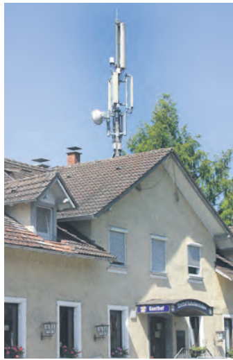
Die »Bl« gibt in Sachen Mobilfunkmast in Markelfingen nicht auf. Derzeit steht eine Antenne auf der Gaststätte »Kutscherstuben«.
