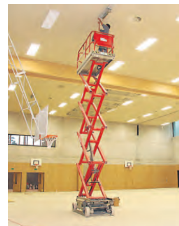
Ins Finale geht bereits der Innenausbau der neuen Hoga-Sporthalle in Stein am Rhein.
