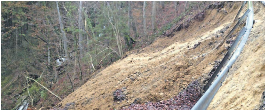
Die abgesackte Straße im Januar. Eine tonnenschwere Eichenwurzel musste vom Bauhof aus dem Graben geborgen werden.
