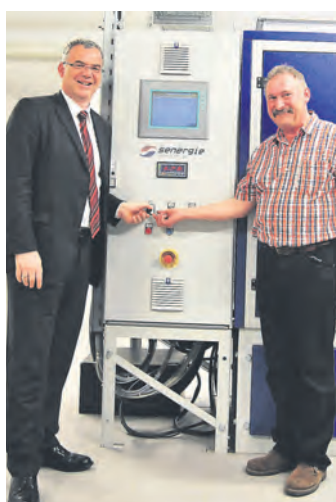
Per Knopfdruck am Netz – Oberbürgermeister Dr. Jörg Schmidt und Kläranlagenleiter Paul Merk nehmen das Blockheizkraftwerk in Betrieb.
