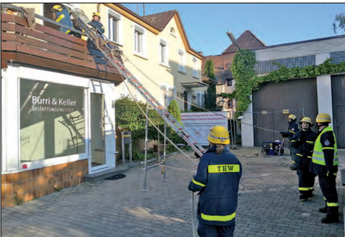
Der THW Ortsverein Radolfzell probte vergangene Woche den Ernstfall: Bei Entkernungsmaßnahmen eines zum Abruch stehenden Hauses ist es am Dienstagabend zu einem Teileinsturz des Gebäudes gekommen. Ein Bautruppf befand sich zum Zeitpunkt des Einsturzes noch im Gebäude. Die insgesamt 16 Helfer bewältigten alle Schwierigkeiten und sind für den Ernstfall gewappnet.
