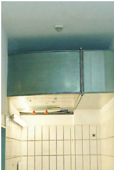
Die Entlüfteranlage in den Toiletten der Hebelschule verhinderte, dass das Glas-Kunstwerk im Treppenhaus dem Brandschutz zum Opfer fiel. swb-Bild: Stadt Singen
