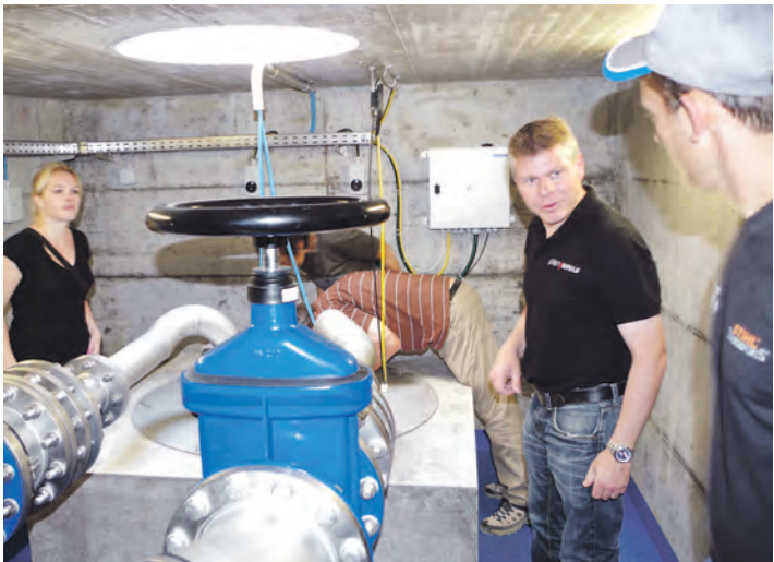
Spannende Einblicke in die Grundwasserpumpgewinnung bot der Tag der offenen Türe im neuen Grundwasserpumpwerk der Stadt Stein am Rhein bei Etwilen.
