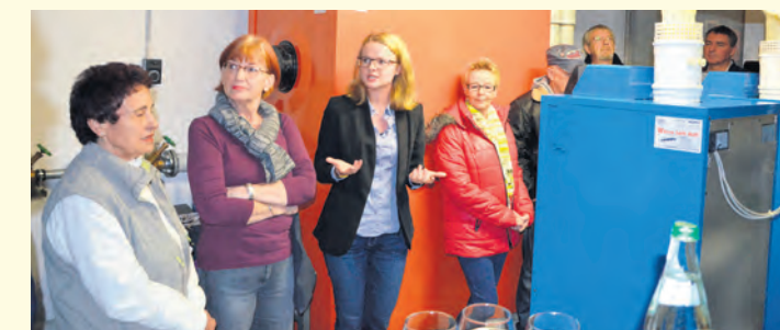
Stefanie Rose (Stadtwerke Radolfzell) zeigt die Vorteile der neuen Heizungsanlage im Mehrfamilienhaus Neuer Wall den Bewohnern auf.
