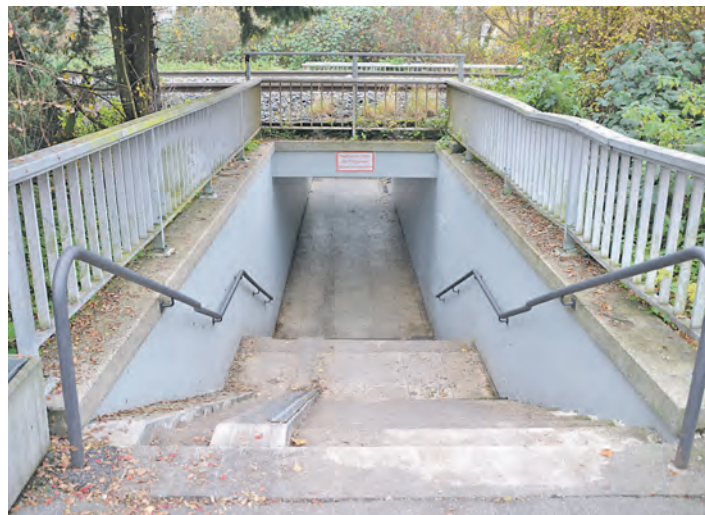
Aufgrund der anstehenden Großprojekte und Kosten von 1,1 Millionen Euro hat die Sanierung der Libellenwegunterführung wohl wenig Chancen auf eine Umsetzung. swb-Bild: gü
