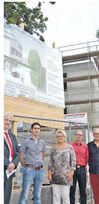
Sie freuen sich über den problemlosen Bauverlauf der neuen Sozialstation in Gottmadingen, von links: Martin Beck, 1. Vorsitzender Sozialstation, Lukas Hahn, Architekt, Elisabeth Waibel, Leiterin der Sozialstation, Architekt Wolfgang Riede und Wolf-Rüdiger Weber, Projektleiter Sozialstation.
