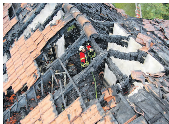
Der ausgebrannte Dachstuhl in Hilzingen.
