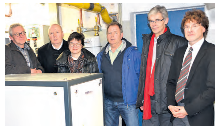
Das neue Blockheizkraftwerk im Spital »Zum heiligen Geist« ist in Betrieb. Darüber freuen sich Ingenieur Hubert Jauch, Energieberater Gerald Thom, Bürgermeisterin Monika Laule, Wilfried Strobel vom Gebäudemanagement, Hauptamtsleiter Manfred Schwarz und Interimsmanager Martin Volz-Neidlinger.
