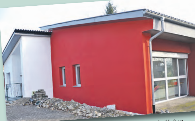
2011 wurde mit den Bauarbeiten am Kindergarten in Hohenfels begonnen, in diesem Jahr werden alle Maßnahmen abgeschlossen sein.
