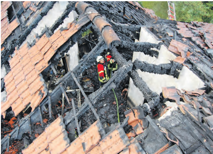
Der ausgebrannte Dachstuhl in Hilzingen.
