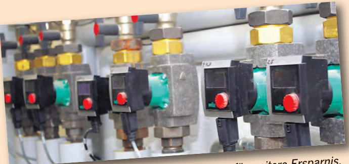
Intelligente Haustechnik und Lüftung sorgt für weitere Ersparnis.
