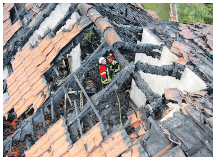
Der ausgebrannte Dachstuhl in Hilzingen.
