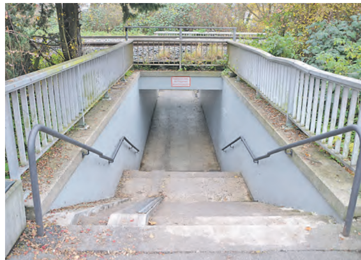
Aufgrund der anstehenden Großprojekte und Kosten von 1,1 Millionen Euro hat die Sanierung der Libellenwegunterführung wohl wenig Chancen auf eine Umsetzung. swb-Bild: gü
