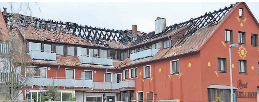
Der Brand hat große Teile des Hotels Kellhof in Markelfingen zerstört.
