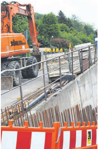
Die Sanierung der Stützmauer in der Bürglestraße wird wesentlich teurer als geplant. Verantwortlich dafür sind unvorhergesehene Probleme mit dem Fundament. swb-Bild: hz
