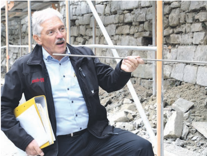
Statiker Franz Riede zeigte dem WOCHENBLATT bei einem Vor-Ort-Termin die starken Schäden an der Grabenmauer im Stadtgarten. Bis im Frühjahr soll der erste von vier Bauabschnitten abgeschlossen sein.
