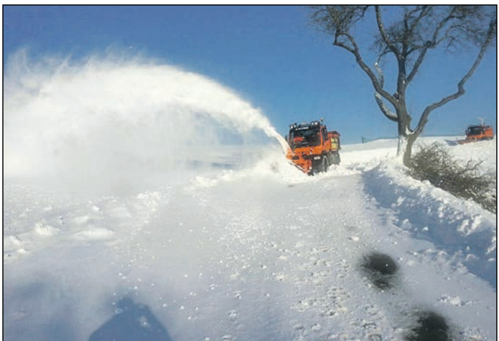
Nach dem stürmischen Winterwetter türmten sich auf der Kreisstraße zwischen Stetten und Leipferdingen teilweise bis zu 1,50 Meter hohe Schneeverwehungen auf. Nach einem Wochenendeinsatz des Winterdienstes war die Strecke am späten Samstagabend wieder befahrbar. Auch für die gestandenen Mitarbeiter der Straßenmeisterei waren diese Schneemassen nicht alltäglich, wie Jürgen Schilling verrät: »In meiner 25-jährigen Laufbahn habe ich so etwas noch nie gesehen!«
