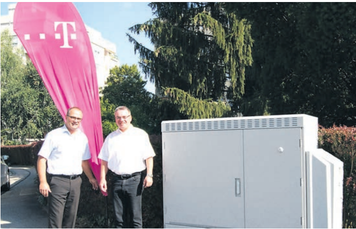
Bürgermeister Ralf Baumert mit Klaus Domscheit von der Telekom am neuen Verteilerkasten im Junkernbühl. swb-Bild: Gemeinde
