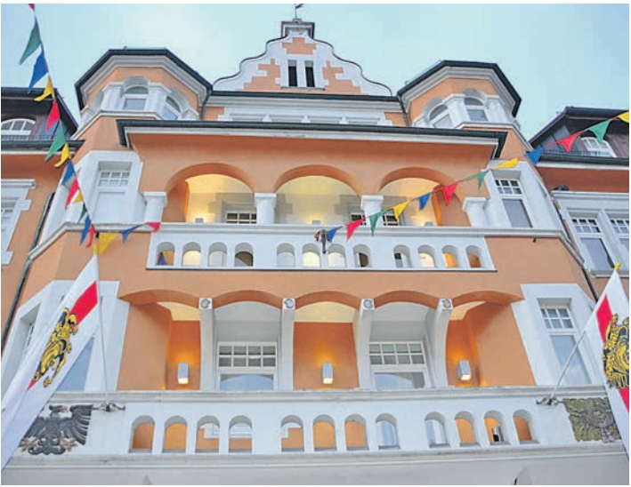
Tauben setzen der Fassade des Bürgerhauses »Adler Post« in der Hauptstraße in der Stockacher Oberstadt stark zu.
