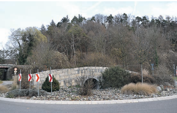
Der »Zollbruck«-Kreisel bei Nenzingen wird vom Landratsamt als nicht verkehrssicher eingestuft. swb-Bild: sw
