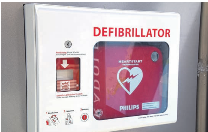
Er ist am Bahnhof wieder nutzbar: Der freizugängliche Defibrillator, der erst vor wenigen Wochen von der Bürgerstiftung installiert wurde. Er wurde vergangene Woche Opfer von mutmaßlicher Zerstörungswut Unbekannter. swb-Bild: gü
