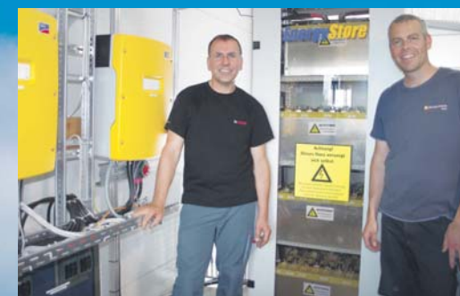
Wolfgang Danner und Daniel Reichle vor dem hochmodernen Stromspeicher, der genügend Strom für den Betrieb der Kfz-Werkstatt liefert.
